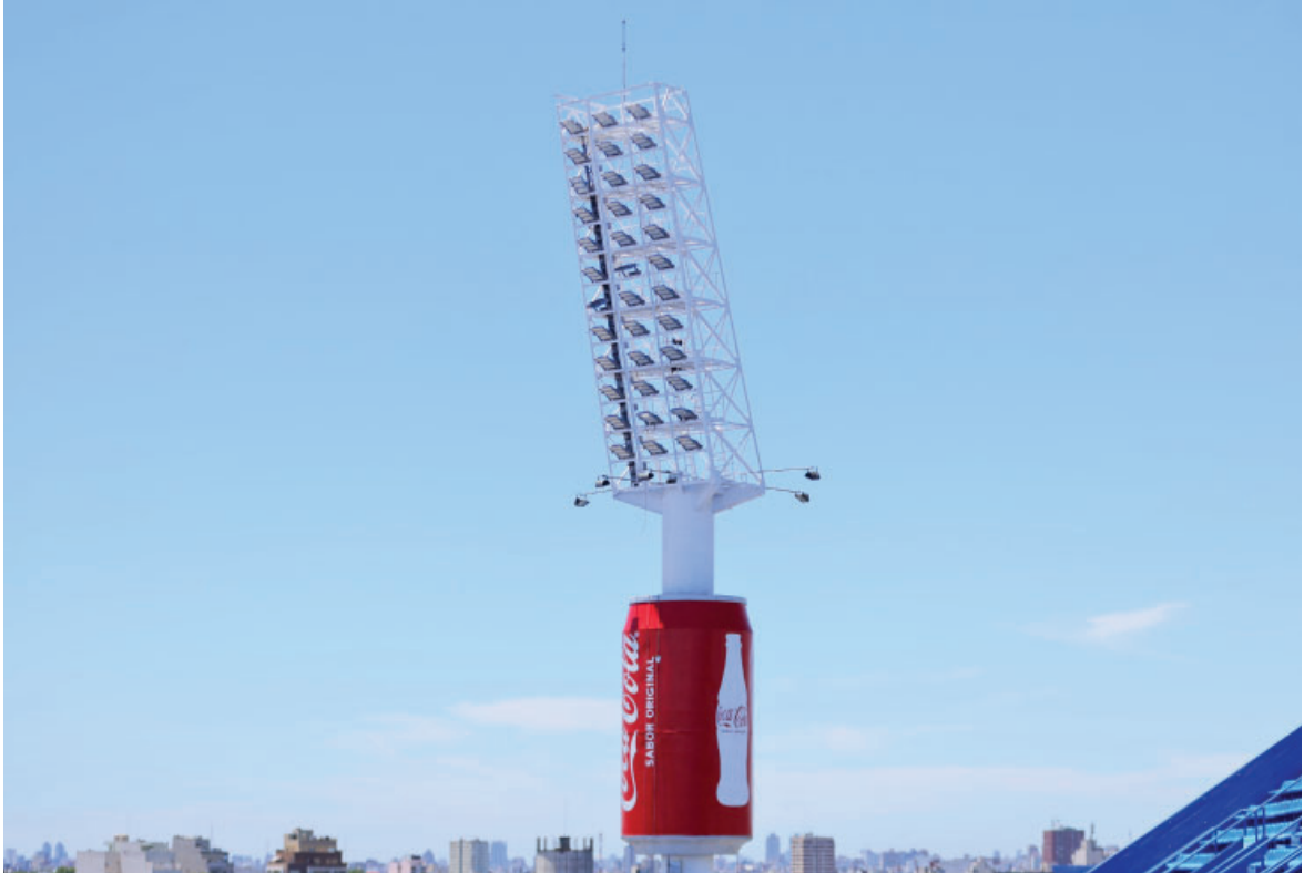
Obra histórica para nuestro Club, dejando atrás una tecnología de casi 50 años y renovando todas las luminarias del Estadio.
